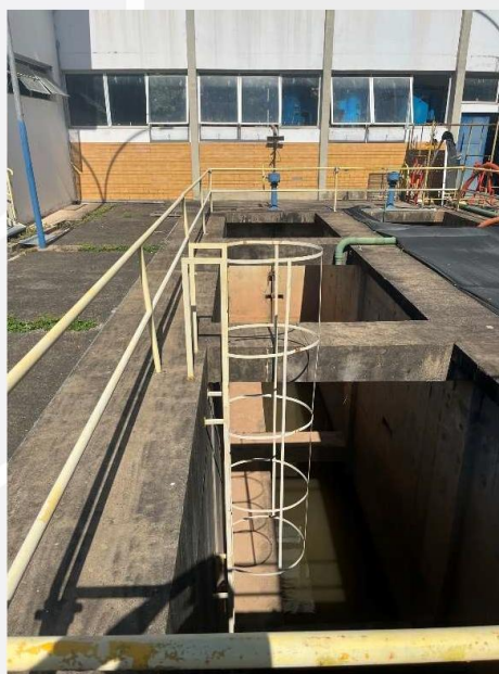
Foto 2 - Estação Elevatório de Água – Visita dia 03/05/22
