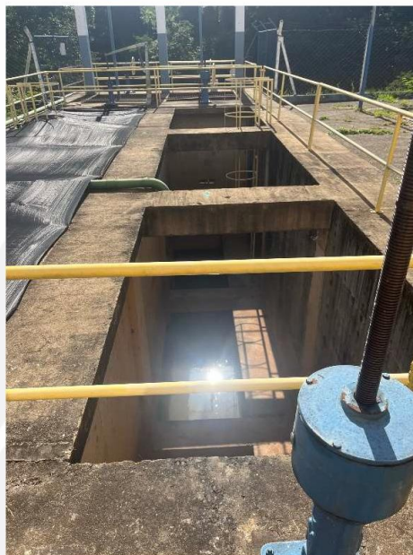
Foto 1 - Estação Elevatório de Água – Visita dia 03/05/22
