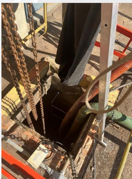
Foto 4 - Estação Elevatório de Água – Visita dia 03/05/22
